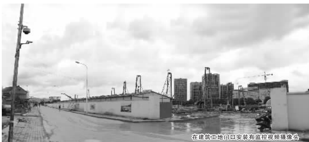
在建筑工地门口安装有监控视频摄像头
